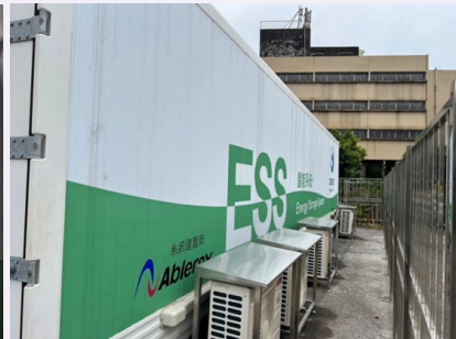
中華電信 ESS 1MW
