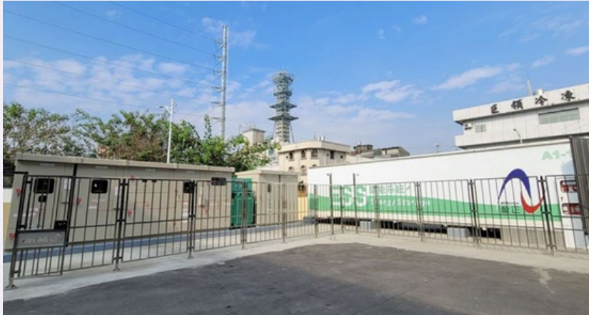
屏東一廠 ESS 1MW
